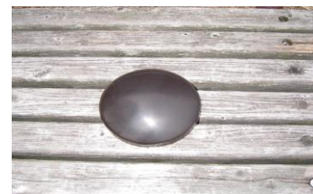
1999年に設置したウッドレールのEキャップ
